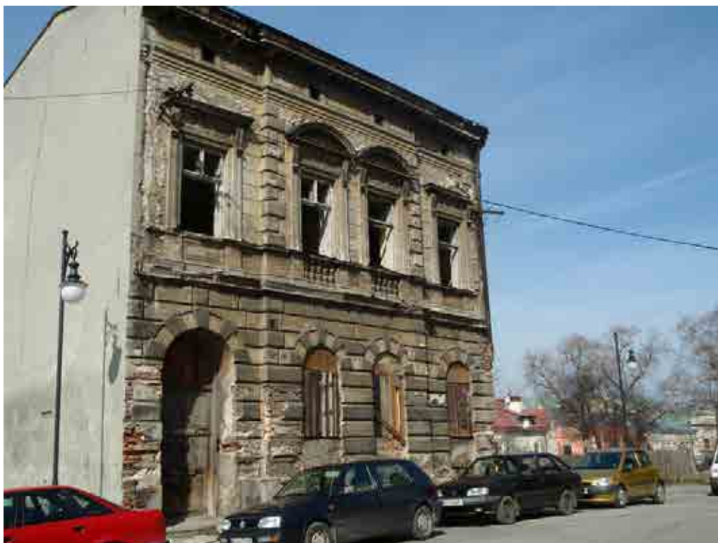
Fot. 23. Opuszczona kamienica przy ul. Ordynackiej (Fot. autorki).
